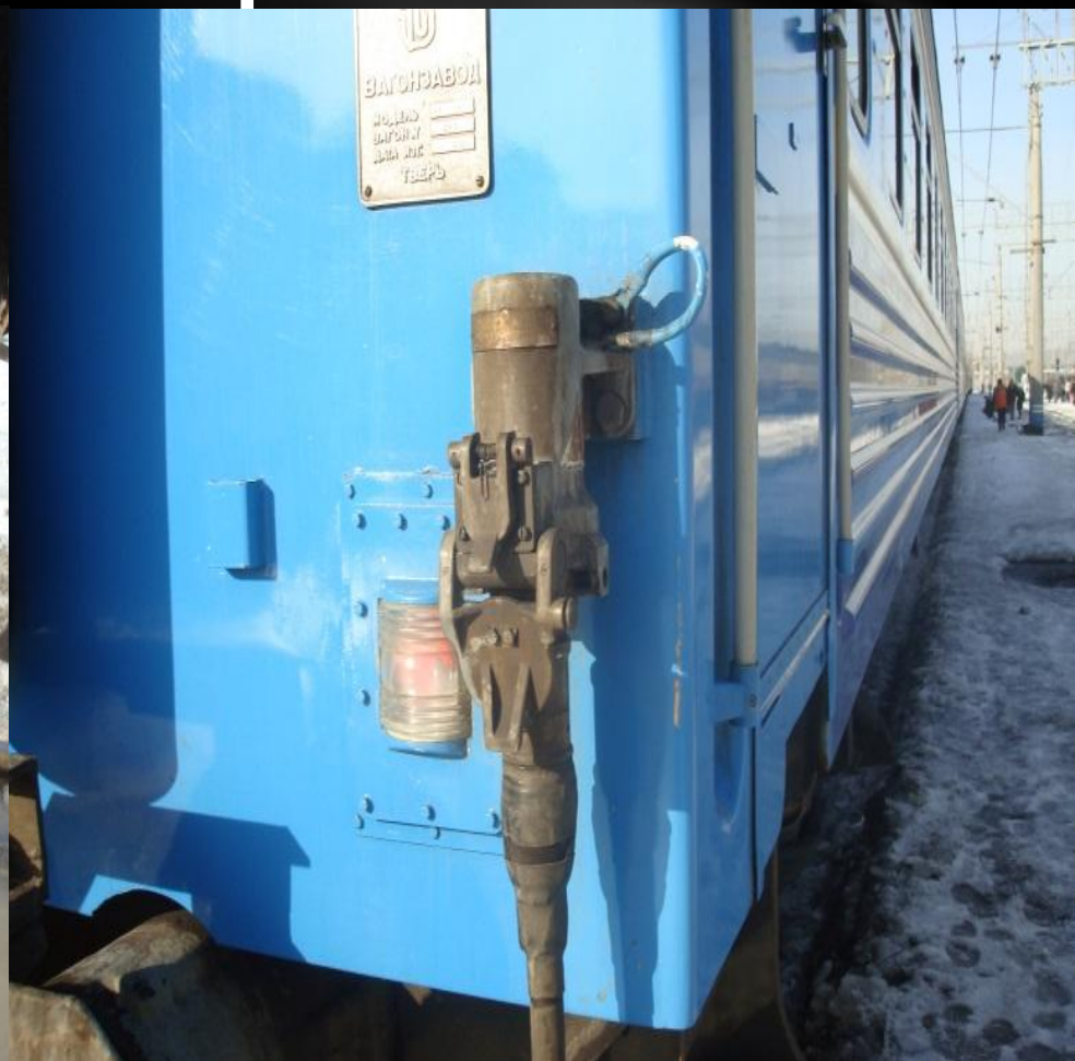
Холостая розетка высоковольтного отопления
