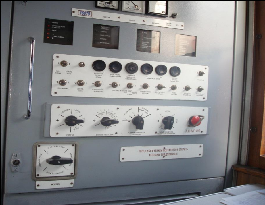
Электрощит купейного вагона 110В производства ГДР
