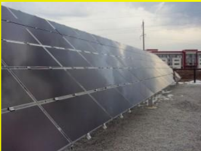
Солнечная электростанция в Белгородской области
