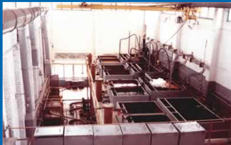
•Станция нейтрализации сточных вод
