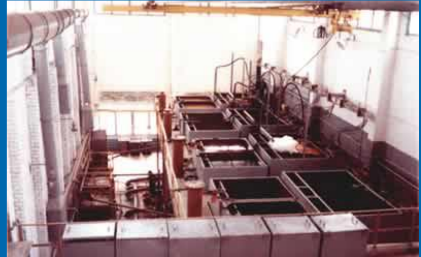
•Станция нейтрализации сточных вод
