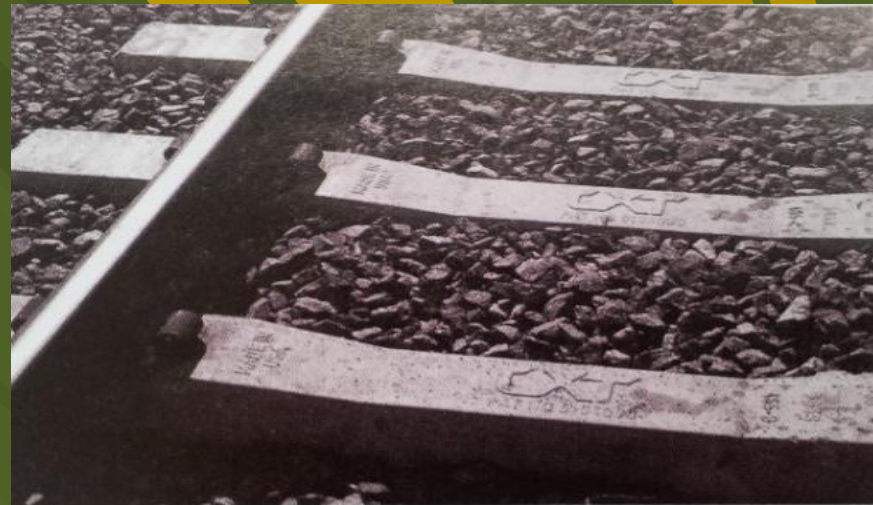
Рис. 1. Путь на железобетонных шпалах компании СХТ
