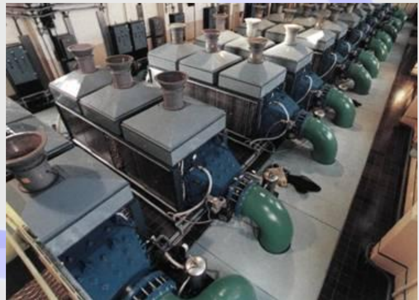
Станция УФ очистки стоков
