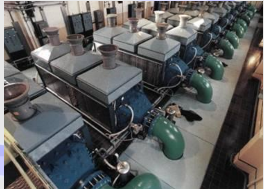
Станция УФ очистки стоков
