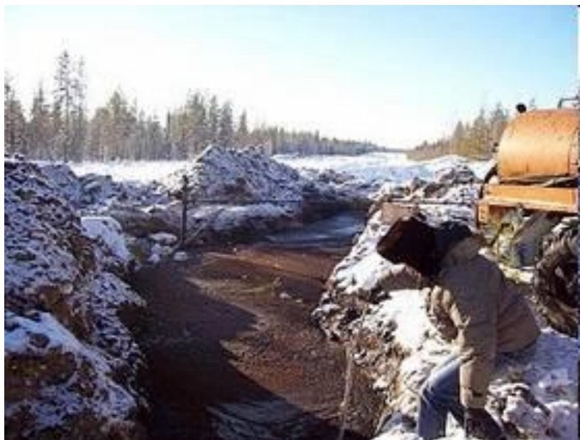
Алнашский район 2010 г. Причина - несанкционированная врезка в трубу
