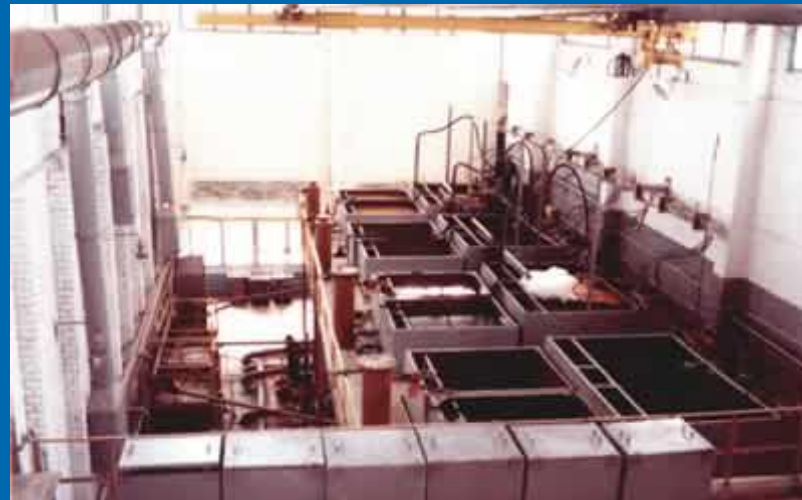
•Станция нейтрализации сточных вод
