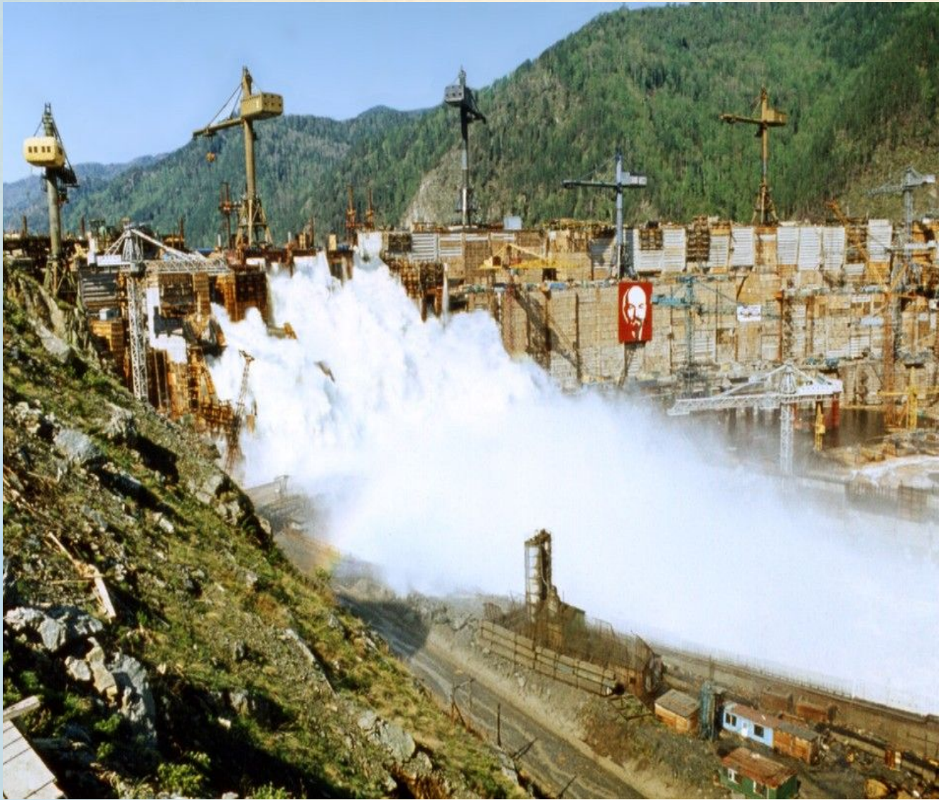
Май 1979 года. Пропуск паводка через водосбросную часть плотины. Здание ГЭС затоплено.
