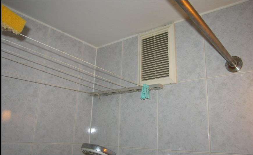
Обычная вентиляция в ванной
