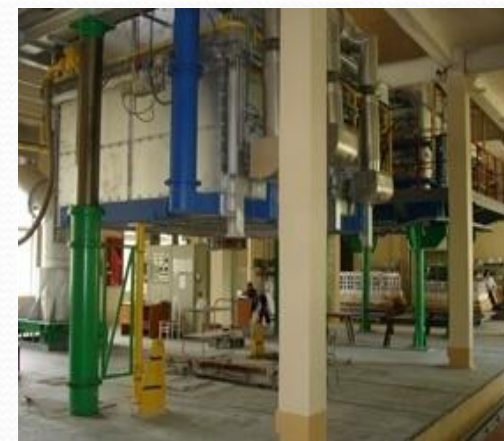
Обжиг деталей печь газовая Wistra1,2 (Германия)
