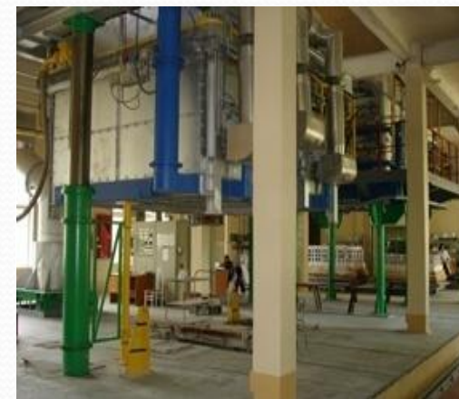
Обжиг деталей печь газовая Wistra1,2 (Германия)
