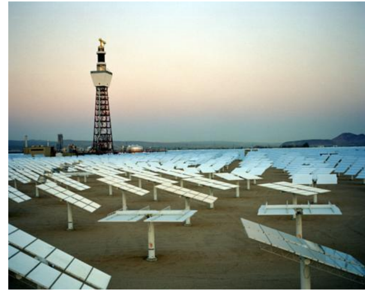
Гелиотермальная электростанция в Калифорнии
