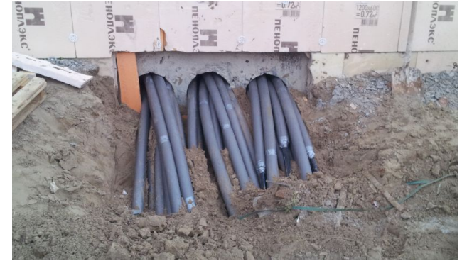
Отопительные трубки подведены к зданию школы.
