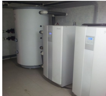
Тепловой насос Danfoss, который отапливает Вершининскую школу.
