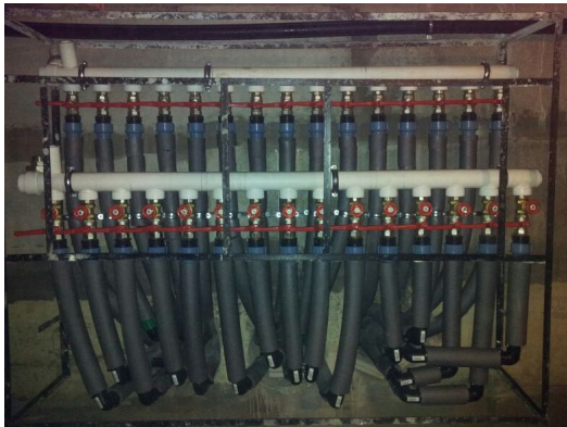
Запорная арматура подземного контура.
