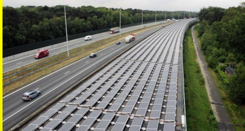
Тоннель с солнечными батареями
