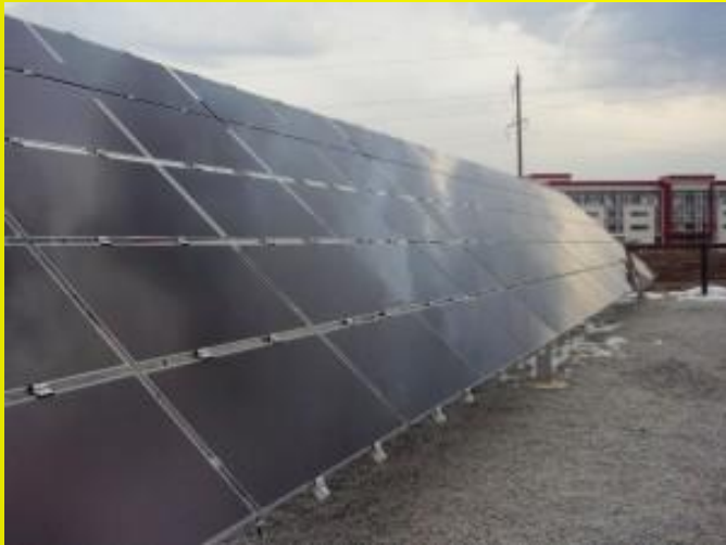
Солнечная электростанция в Белгородской области
