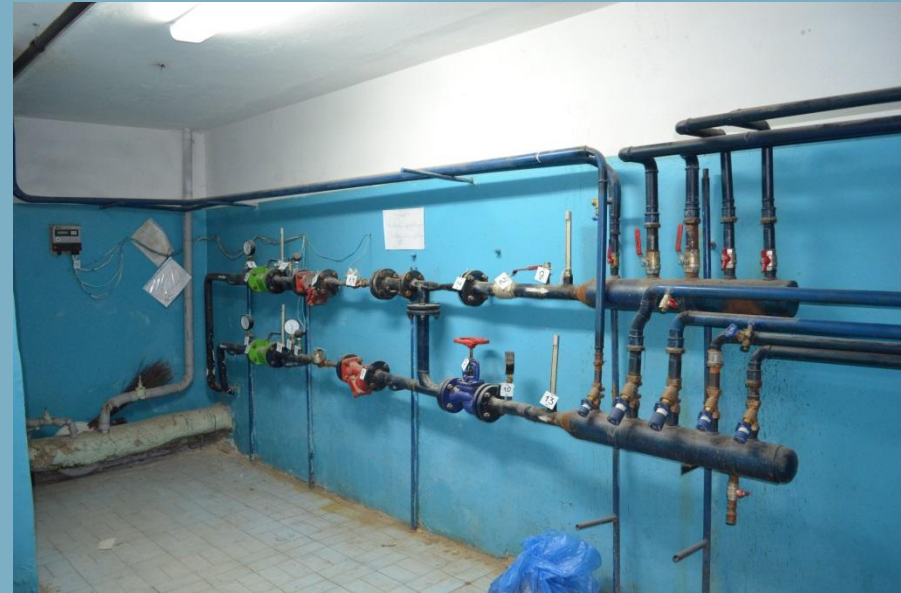
Тепловой узел 6 мкр. Д.6 ТЦ «Спутник»
