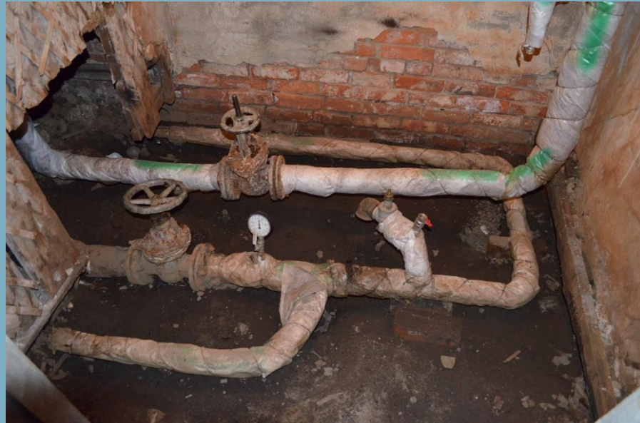
Тепловой узел Комсомольская д.1
