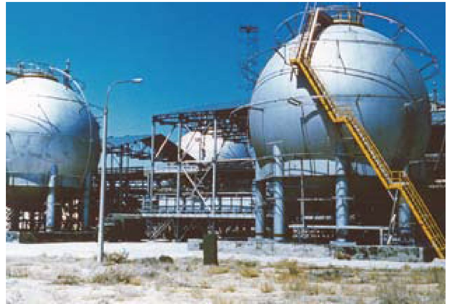
Кріорезервуари для зрідженого кисню (Байконур, Казахстан)
