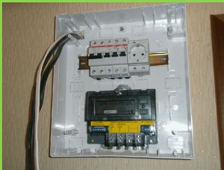
Пробная сборка щита без коммутации
