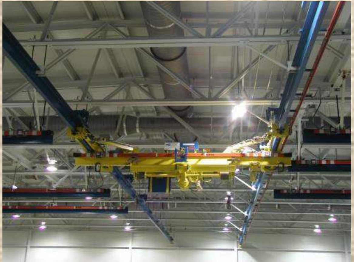
Троллейный шинопровод в помещении цеха
