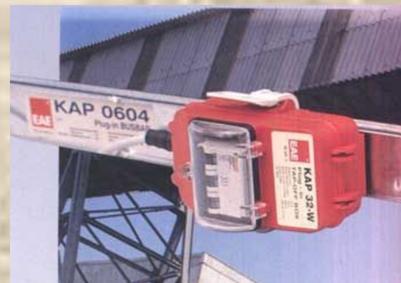
Секция со штепсельной колоткой
