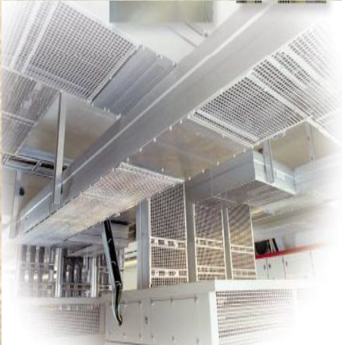
Пример электрической сети, выполненной магистральным шинопроводом MDY
