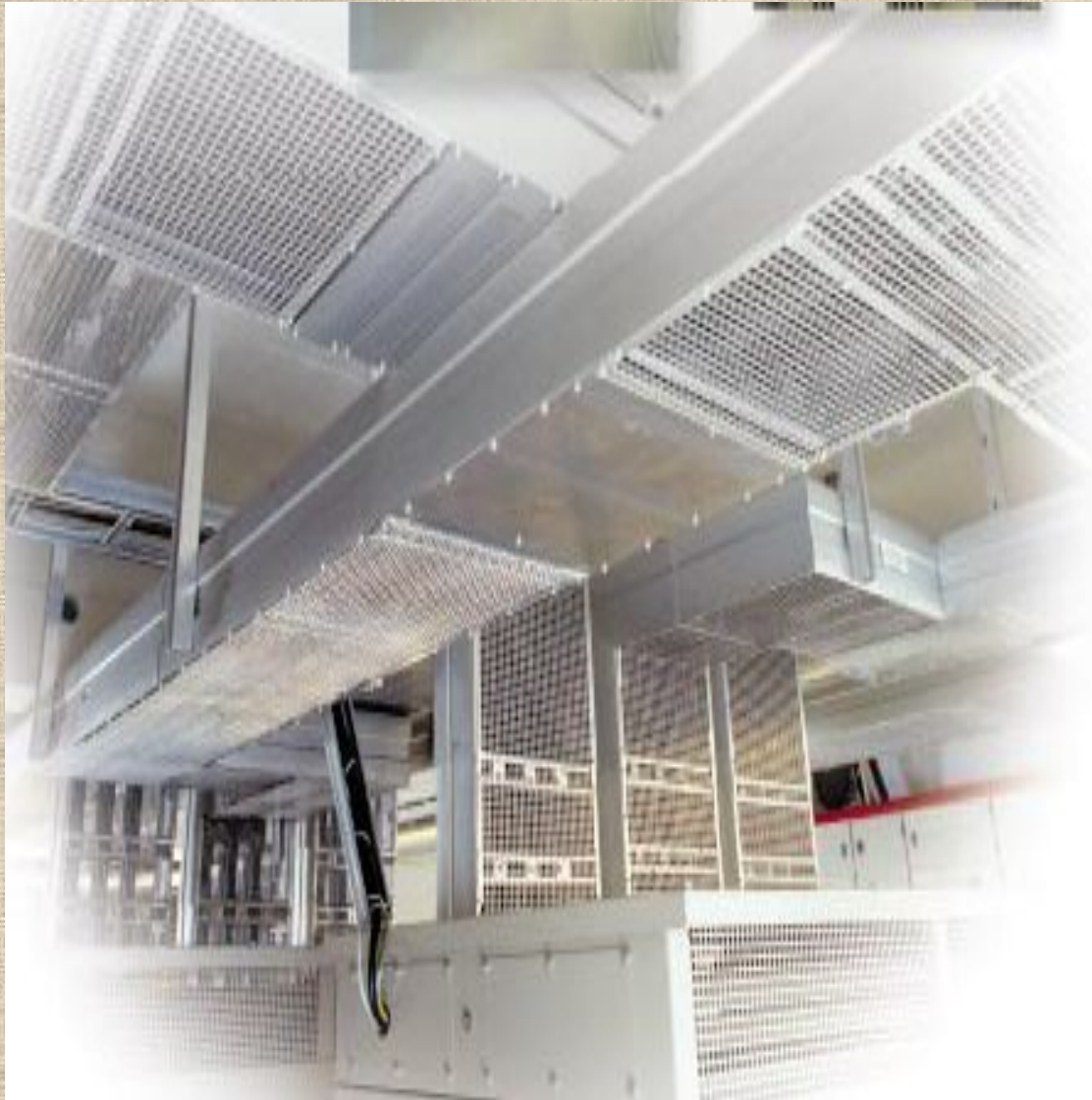
Пример электрической сети, выполненной магистральным шинопроводом MDY
