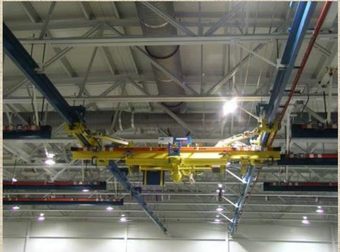
Троллейный шинопровод в помещении цеха
