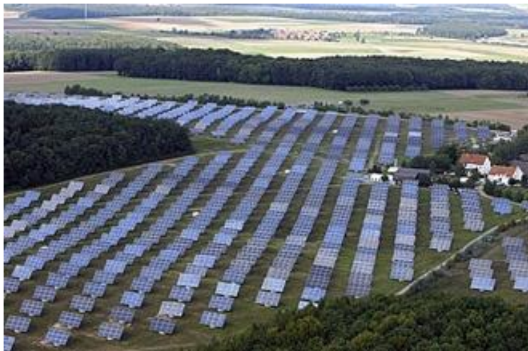
Солнечная электростанция в Германии
