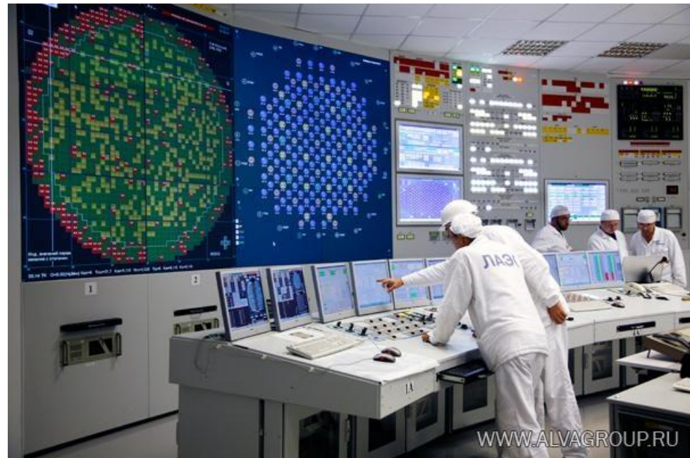
Блочный щит управления
