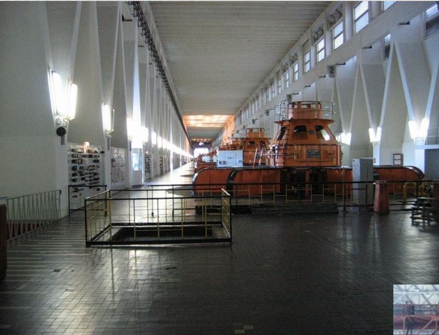
Машинный зал Братской ГЭС
