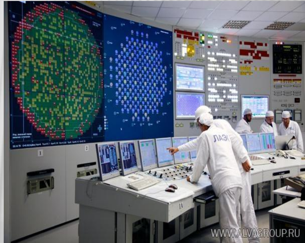
Ленинградская АЭС. Блочный щит управления
