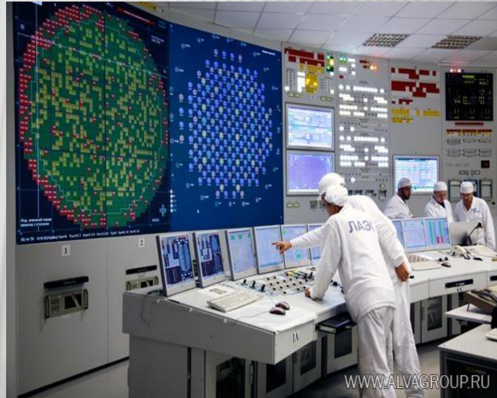
Ленинградская АЭС. Блочный щит управления
