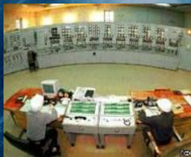
Центр управления АЭС
