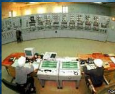
Центр управления АЭС
