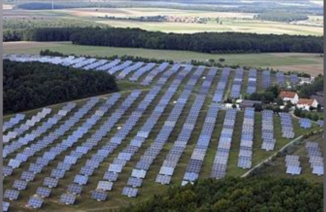
Солнечная электростанция в Германии
