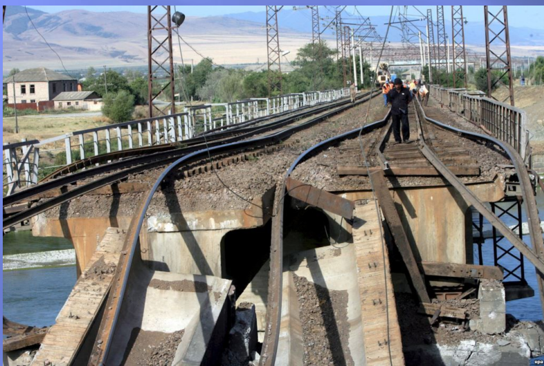
Остатки железнодорожного моста через р.Ингур
