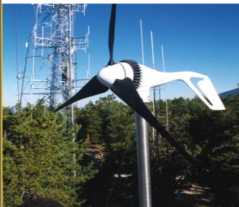
Электроэнергия для телекоммуникационной башни, Аризона, США
