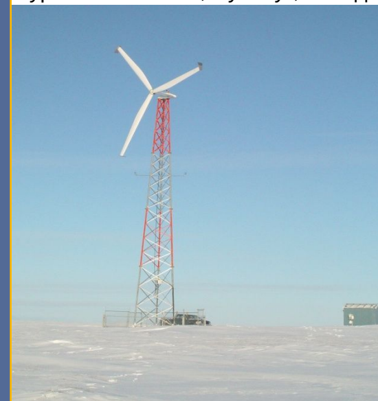
Турбина на 50 кВт, Нунавут, Канада
