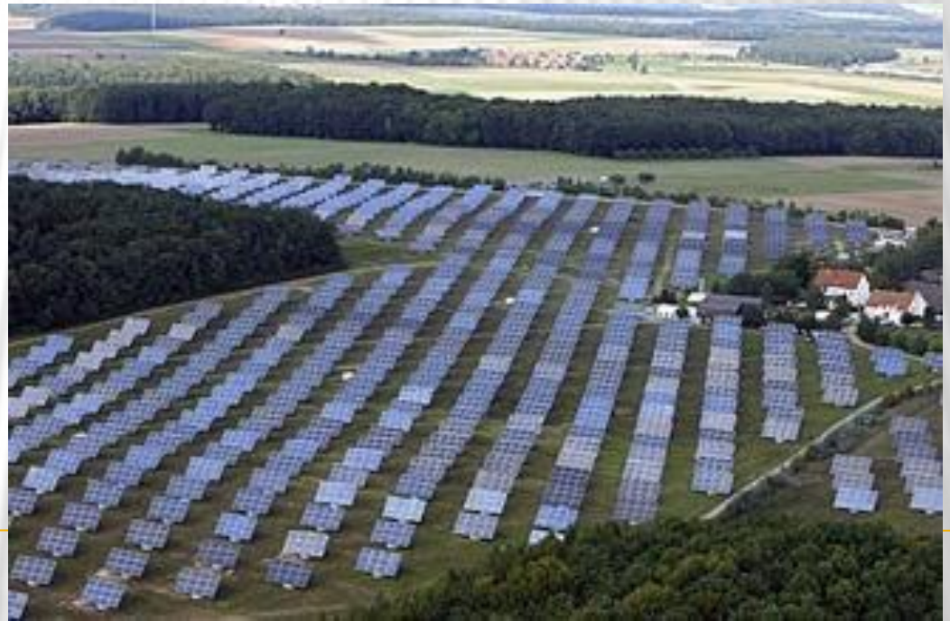
Солнечная электростанция в Германии
