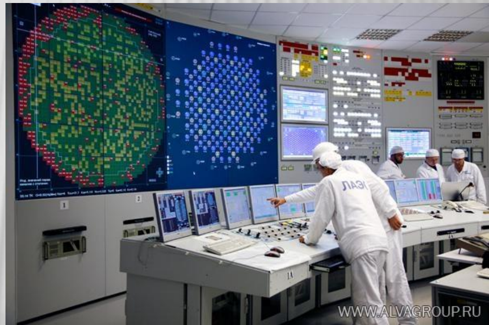
Ленинградская АЭС. Блочный щит управления
