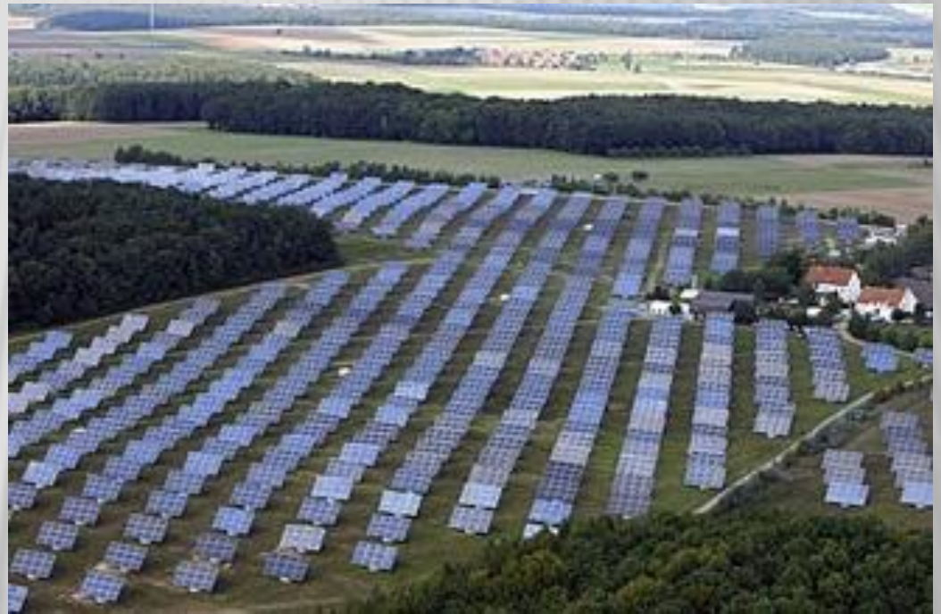
Солнечная электростанция в Германии
