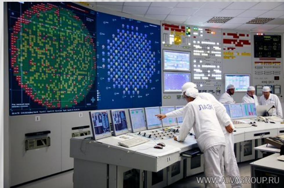
Ленинградская АЭС. Блочный щит управления
