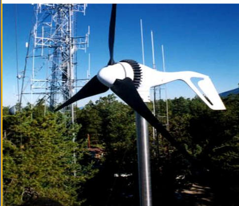
Электроэнергия для телекоммуникационной башни, Аризона, США
