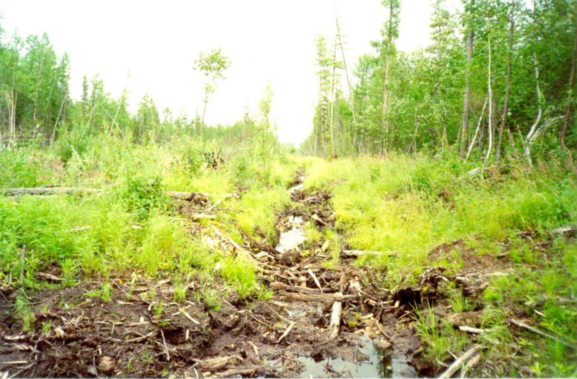
Термоэрозия в сильнольдистых грунтах по вездеходной дороге на просеке нефтепровода
