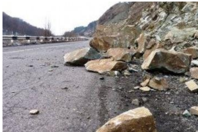
Осыпь, обвал, камнепад
