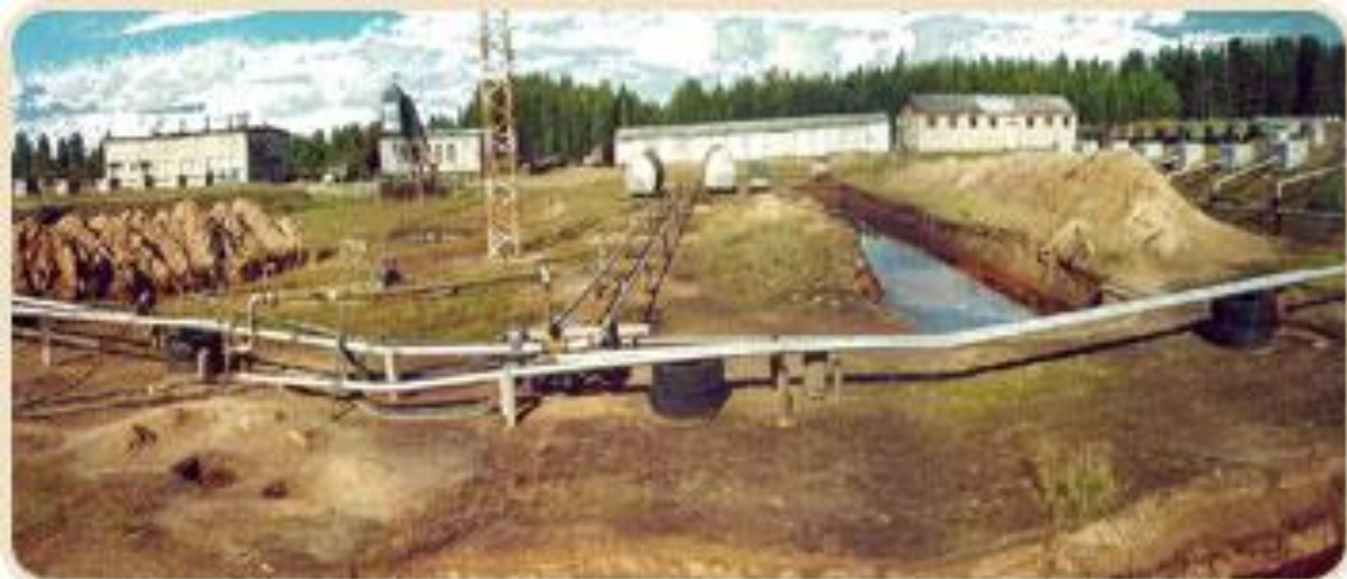
Сооружение для очистки подземных вод
