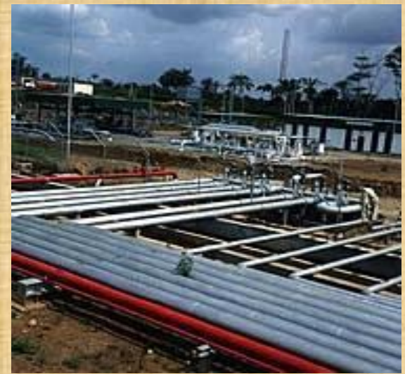
Насосная станция нефтепровода.
