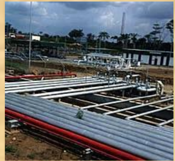
Насосная станция нефтепровода.
