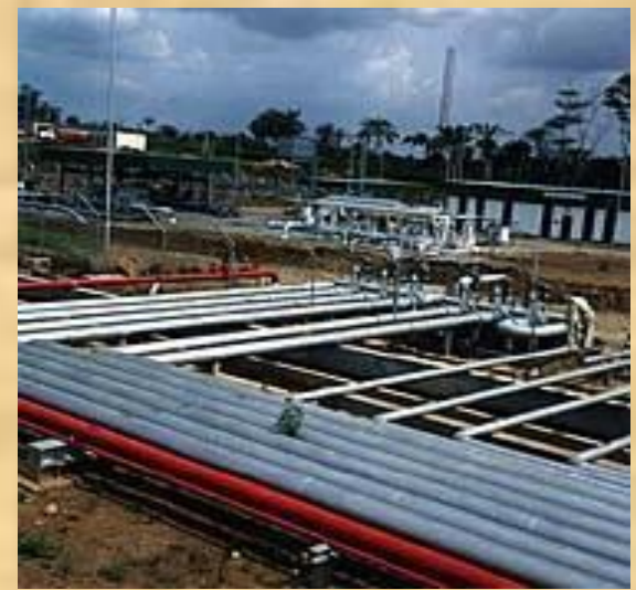
Насосная станция нефтепровода.
