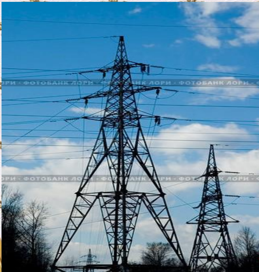
Высоковольтные линии электропередачи.
