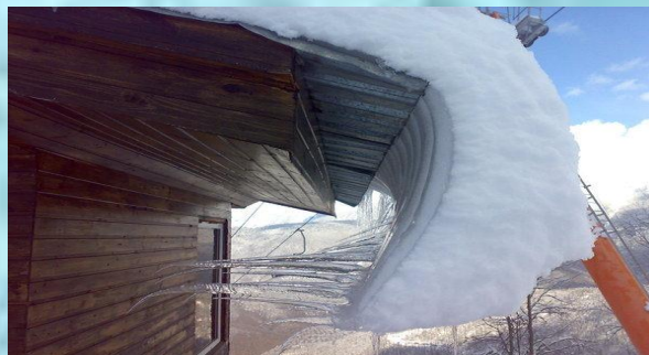
Опасны огромные сосульки, падающие с крыш домов
