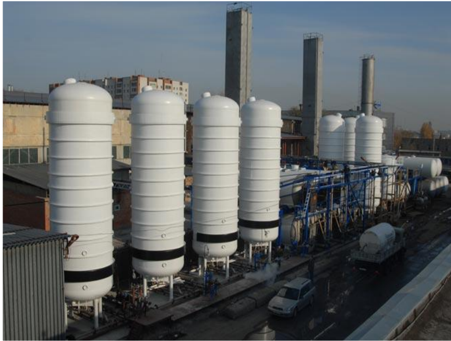
Завод по производству азота из жидкого воздуха
