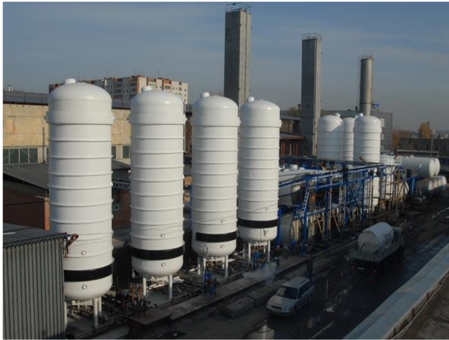
Завод по производству азота из жидкого воздуха
