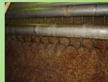
ЦБК. Варочный цех
