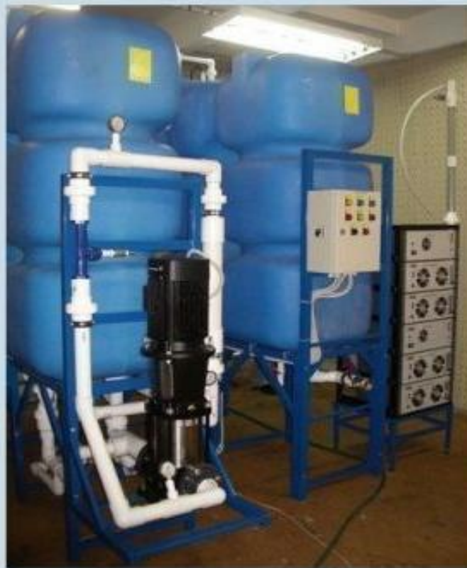
Станция озонирования для обезжелезивания воды
