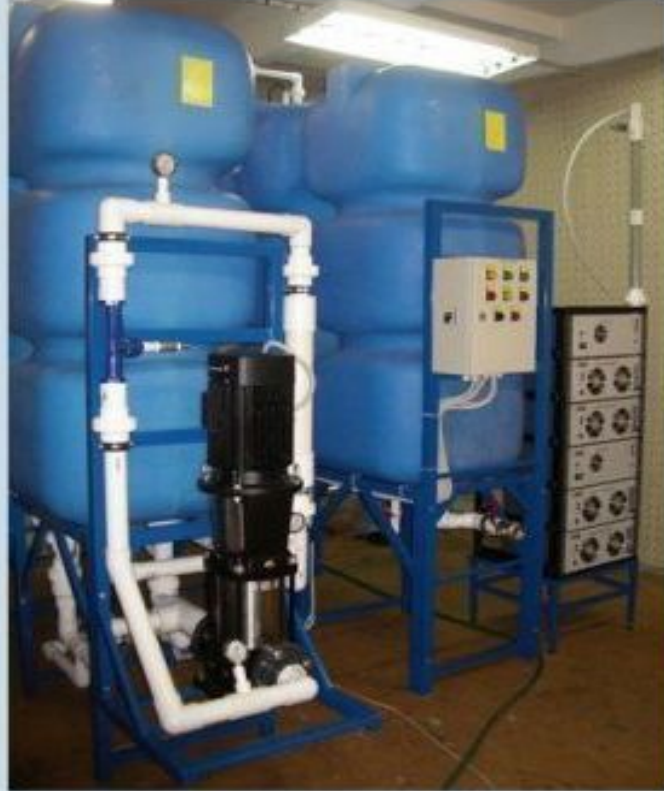
Станция озонирования для обезжелезивания воды
