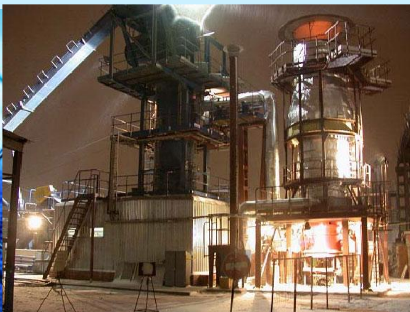
Установка по газификации твердого топлива производства ФГУП «НПЦ газотубостроения «Салют»»
