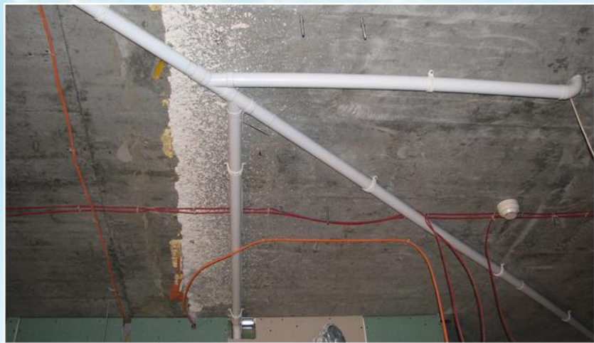
Разводка под потолком
