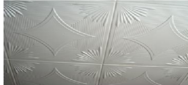
на потолочной плитке
