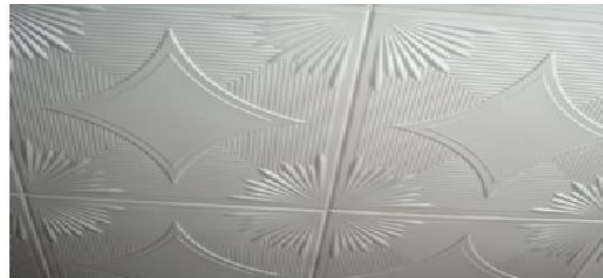
на потолочной плитке
