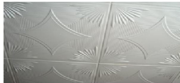
на потолочной плитке
