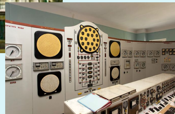
Обнинская первая атомная электростанция АЭС.
