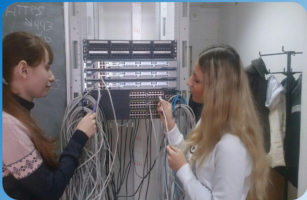
Стойка с маршрутизаторами и роутерами
