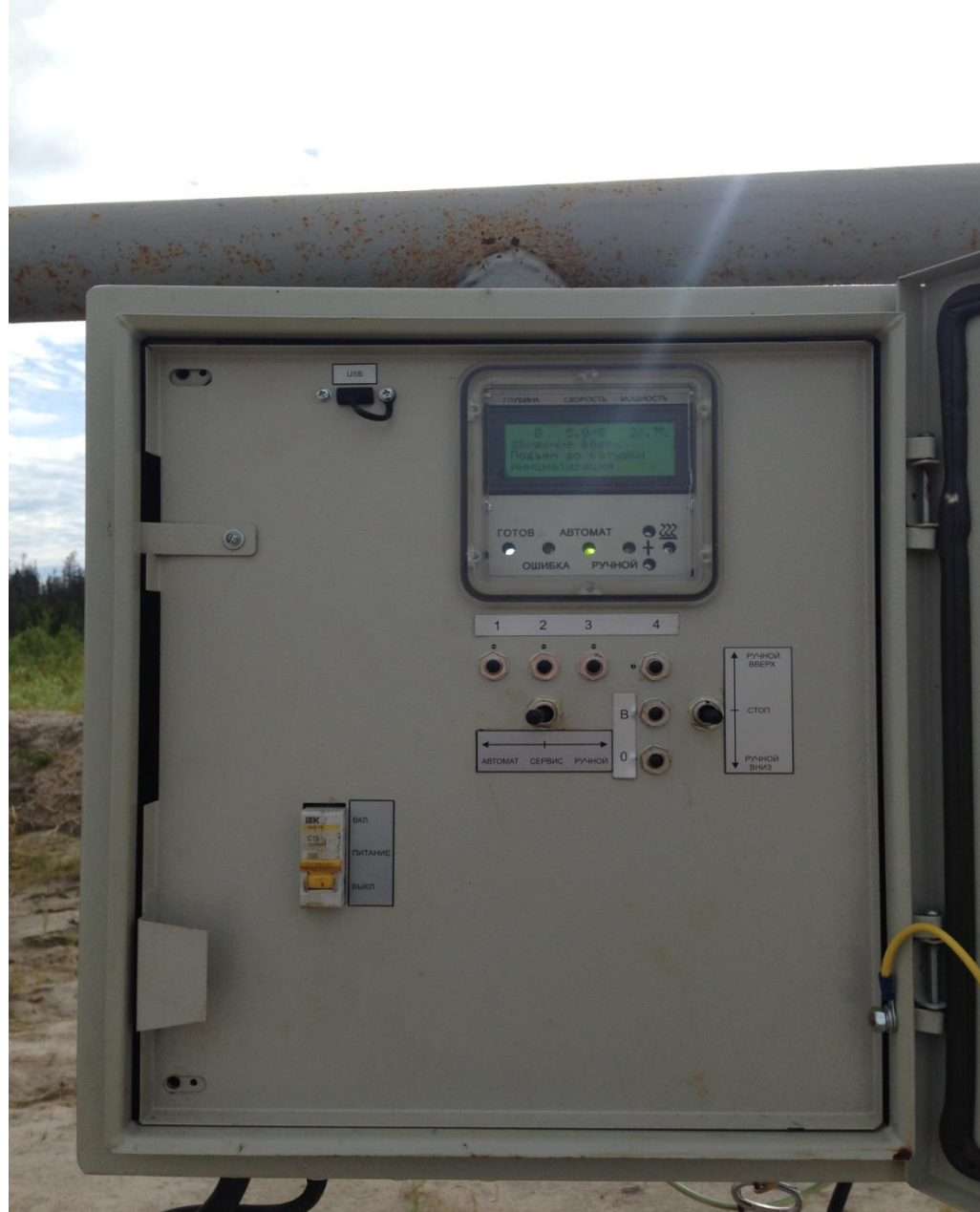
«Станция управления лебедкой»
